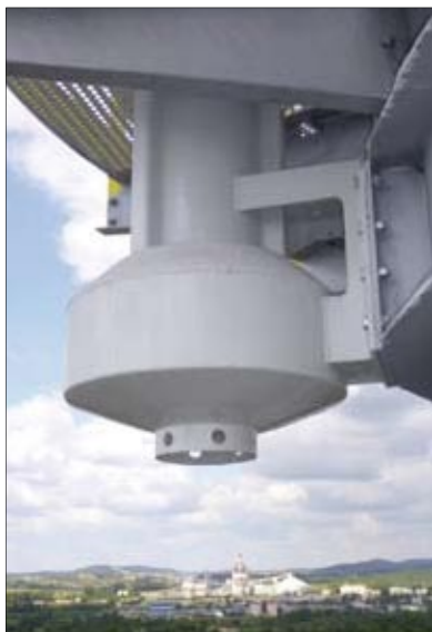
Tłumik drgań poprzecznych zainstalowany na kominie stalowym H=60 m
