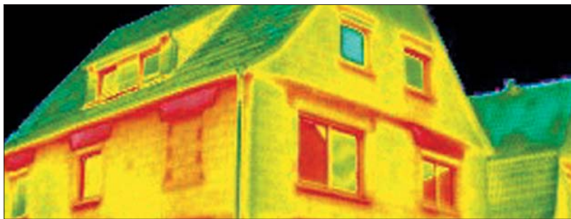
Obraz termowizyjny budynku wskazuje miejsca o obniżonej izolacyjności
